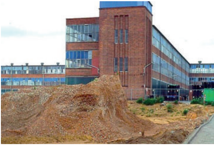
Schon vor 2000 gab es Abbrüche auf dem BLM Gelände zwischen F-Bau und der Gesenkschmiede.
