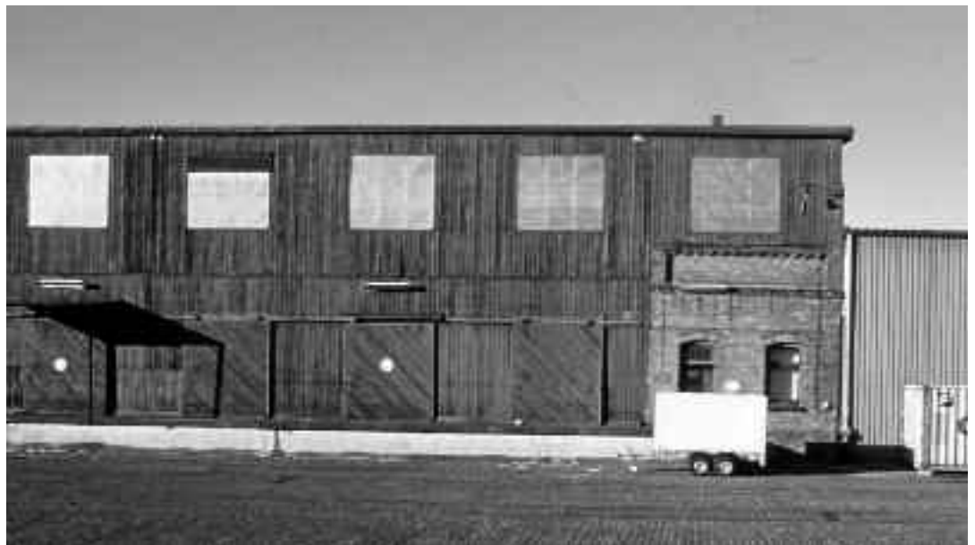
Schuppen C von der stadtzugewandten Seite. Zweigeschossige, solide Ziegel-Holz-Konstruktion. Unten durchgehend Schiebetore, oben große (jetzt vernagelte) Fensterbänder
