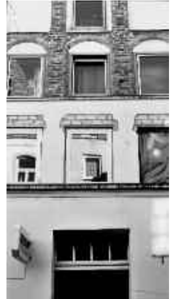
Einscheiben-Drehklapp-Kunststofffenster in einer „Renaissance“-Fassade – ist das eine Lübecker Spezialität? Ein Welterbe-Gag?
