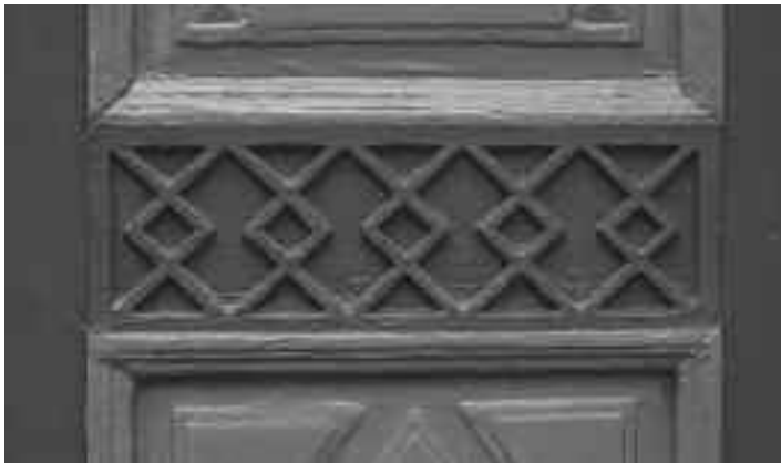
Hartengrube 30. Haustür mit drei Füllungen. Der Fries wird aus sich überlagernden Rauten gebildet.
