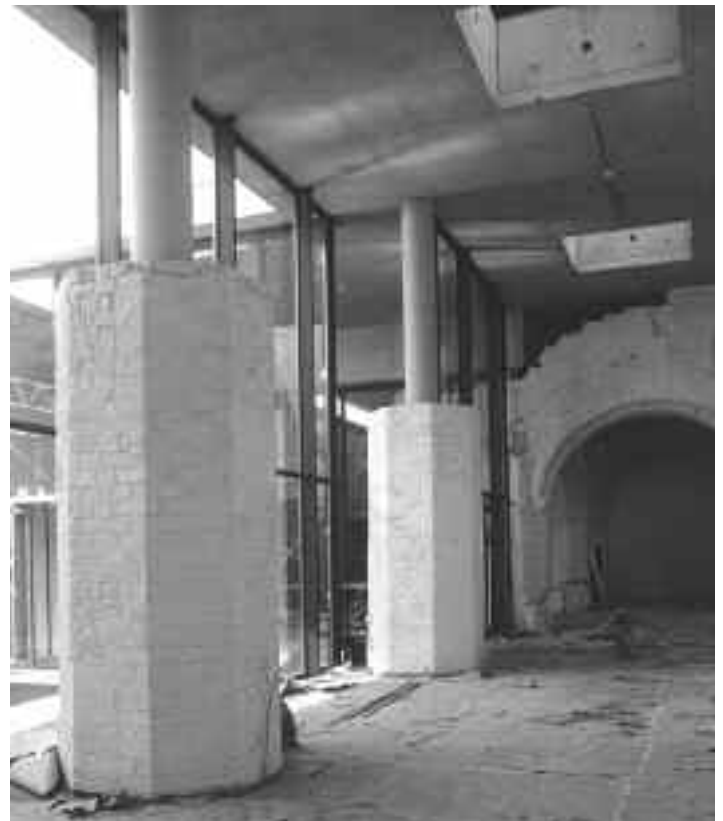
Achteck-Pfeiler, die nicht stützen, sondern als Hohlform notwendige neue Statik camouffieren
