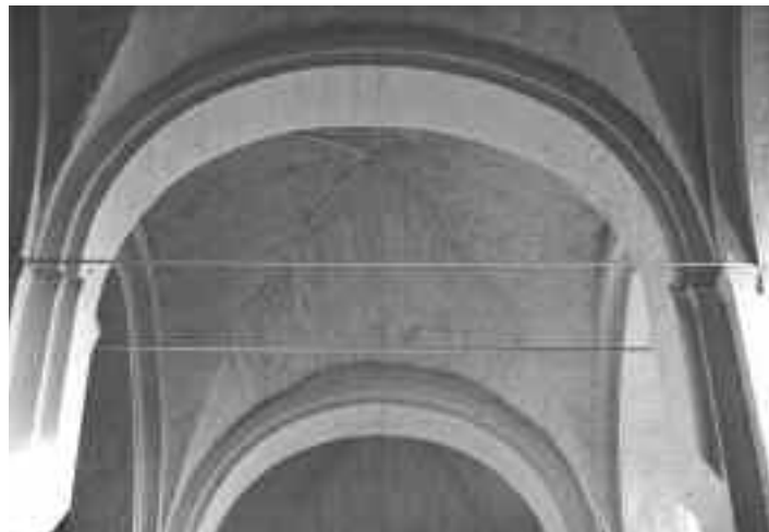
Mittelschiffsgewölbe von etwa 1220/30. Deutlich zu erkennen die Abdrücke der Schalbretter. – Die Gliederung mit den kräftigen Gurtbögen und den Pfeilern oben vorgelegten breiten Konsolen ist westfälischen Ursprungs
