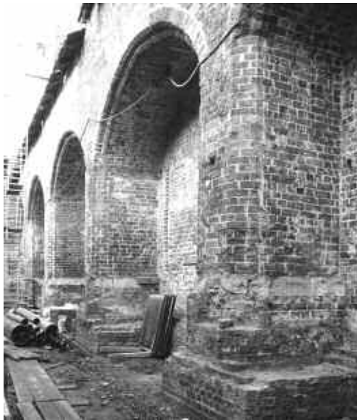
Baustelle St. Annen. Das war eine Chance: das Nord-Seitenschiff mit den tiefen Wand- oder Einsatzkapellen. Der stärkste Eindruck von der ehemaligen Kirche
