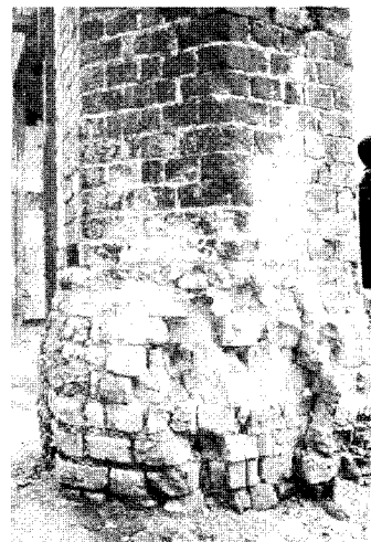
Sockelbereich eines Mittelschiff-Pfeilers. Es gibt noch schlimmere Stellen als diese. Was soll mit diesen zermürbten und zerfrostenen Ziegellagen geschehen? Was für Formen werden die „wiederhergestellten“ Sockel zeigen? Dieser Pfeiler gehören zu denen, die eine Ausbohrung von 40-Zentimetern Durchmesser aushalten sollen (Herbst 2000)
