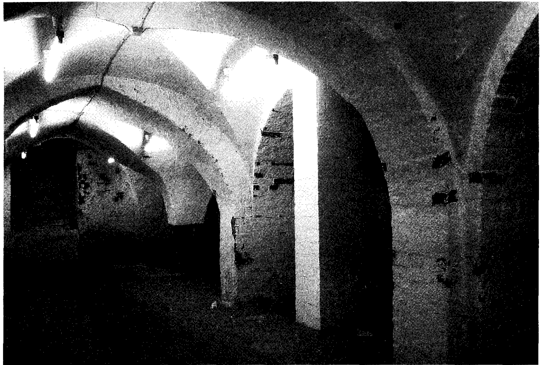
Königstraße 51. Im Bild-Vordergrund eine barocke Keller-Erweiterung (an den breiten Gurtbögen erkennbar. Der glatte Pfeiler ist neu). Hinten der einst „offene“ frühgotische Kaufkeller. Gut erkennbar links die Mauernische des ehemaligen Kellerhalses. - Bis 1990 lagerte hier ein Teil des LN-Archivs.
