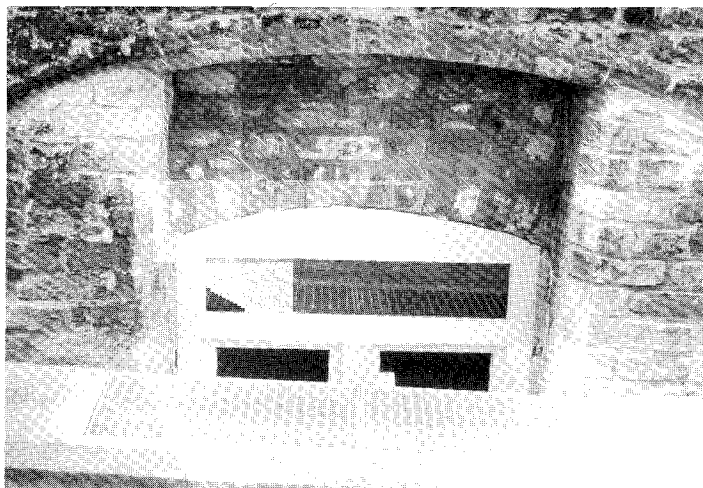
Mengstraße 40. Neue Keller-„Fenster“ an der Blocksquerstraße. Wer wagt angesichts dieses hanebüchernen Entwurfs und dieser schlicht unzulässigen handwerklichen Schluderei noch nach dem Verbleib der gotischen schmiedeeisernen Durchsteck-Gitter zu fragen! Wieso eigentlich „Fenster“ für einen (Gewölbe-)Keller, der laut Aussage der Denkmalpflege gar nicht genutzt werden darf?
