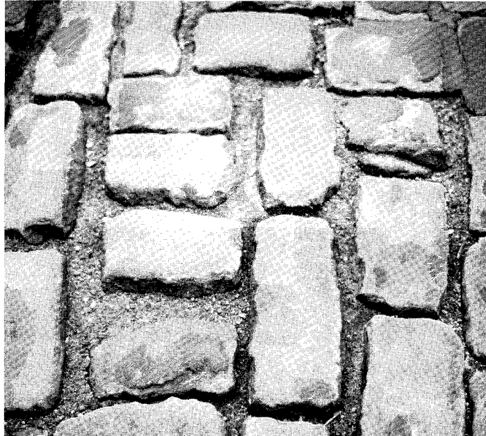
Musterbeispiel: Die Kehrmaschinen der Straßenreinigung saugen die Fugen des Pflasters tief aus. Unfallgefahr besteht. Von Zeit zu Zeit werden die Fugen dann wieder aufgefüllt. Das „Spiel“ beginnt von neuem. Das kostet. Auch dies: die Qualität der Pflasterung (Sommer 1992) ist unglaublich: Fugenbreite bis zu 6,5 cm.
