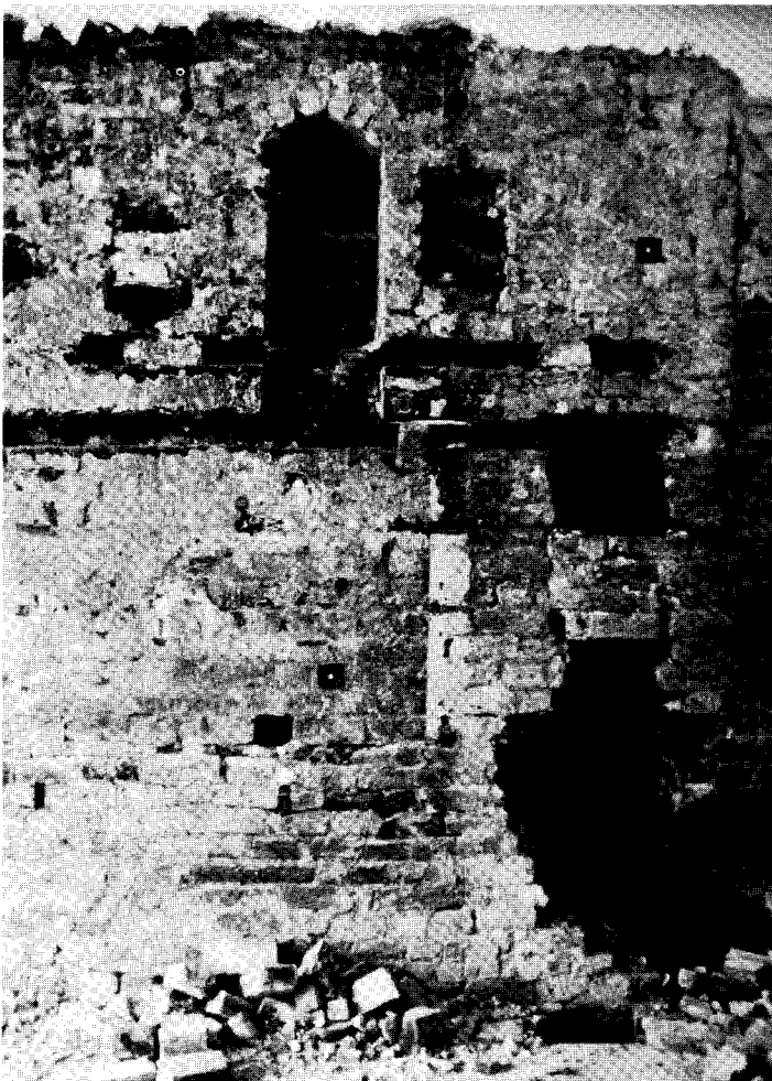
Palmarum '92. Einmalig: mittelalterliche Wandheizung im Obergeschoß von Königstraße 55. Ein „Saal“ nach Adels-Vorbild? Gibt es denn solche Befunde zuhauf, daß man sich den Abbruch so einfach leisten kann? Im Bild die von den Bauforschern geöffneten Schächte und Gänge. Totalverlust.
