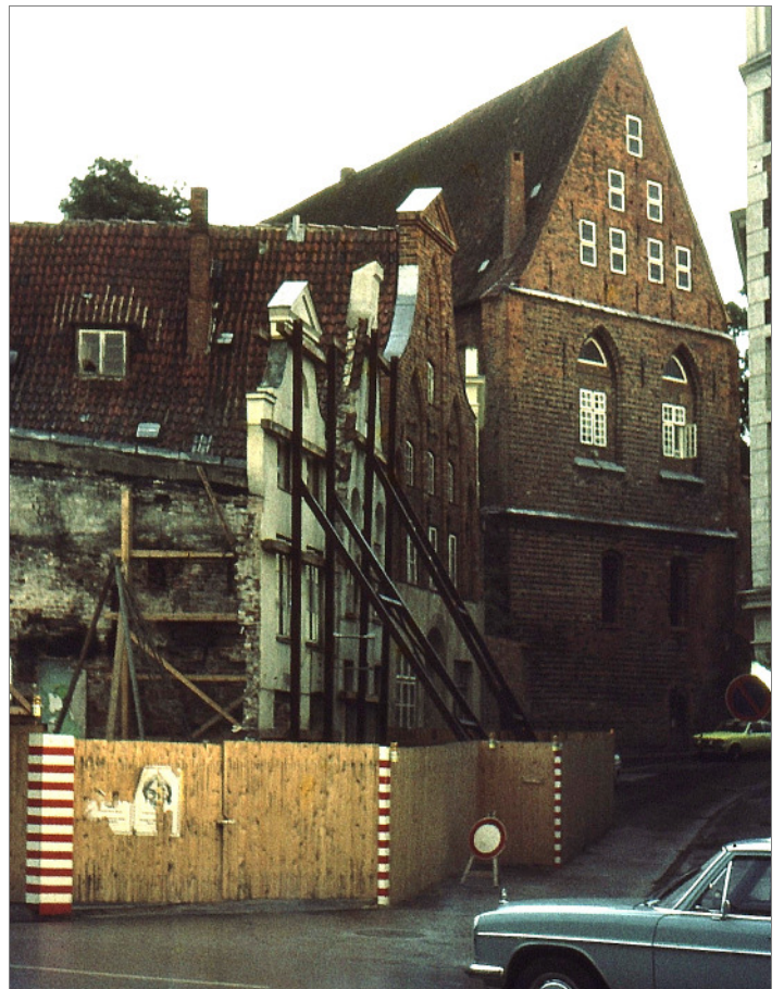
Links oben und unten: Die drei Parzellen Kleine Altefähr 12-16. Fotos: Uwe Haarich, 1971. Rechts oben und unten: 1975, die Giebel Kleine Altefähr 12 und 14 im Stützkorsett. Der Neubau der Seefahrer-Einrichtungen steht an. 40 Jahr später das gleiche Bild: Dann „dockt“ hier das Hansemuseum an. Fotos: Manfred Finke.
