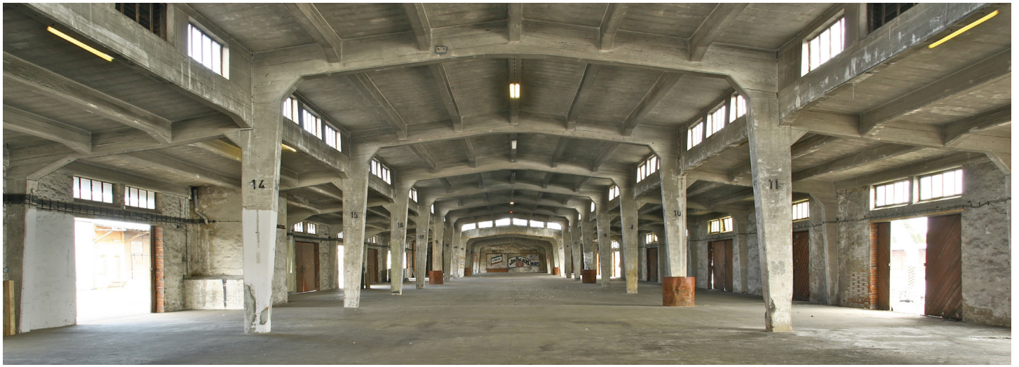
Bild oben: Die große Halle von Süden nach Norden. An einen Mittelrahmen sind jeweils zwei einhäufige Seitenrahmen angehängt. Dadurch kann das Dach gestaffelt werden und einen Lichtgaden ausbilden. Foto: Thomas Radbruch.
